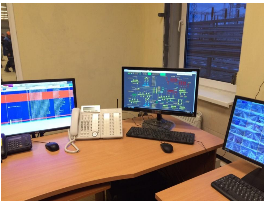
ПК с установленным АРМ Оператора ЛАПНУ в работе
