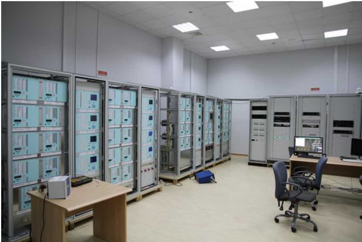
Рис. 4.9.1 – Комплексные испытания вторичного оборудования пр-ва НПП ЭКРА
